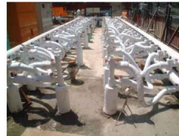
地上部の配管
