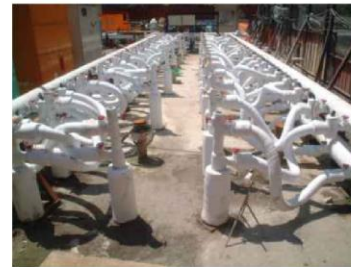
地上部の配管
