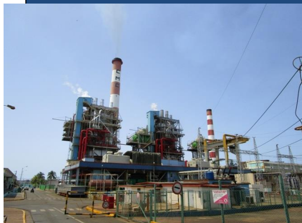
日立製作所の設備が稼働する シエンフエゴス発電所
