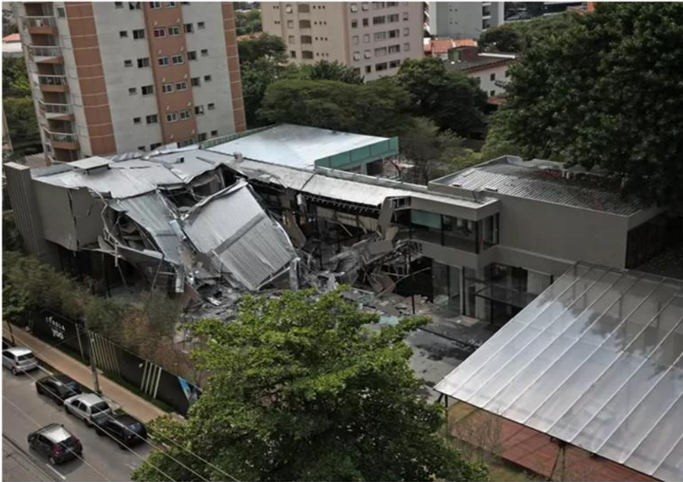
Estande de vendas de um prédio a ser construído é visto após desabar na Vila Olímpia, na Zona Sul de São Paulo (Foto: Fábio Tito/G1)
