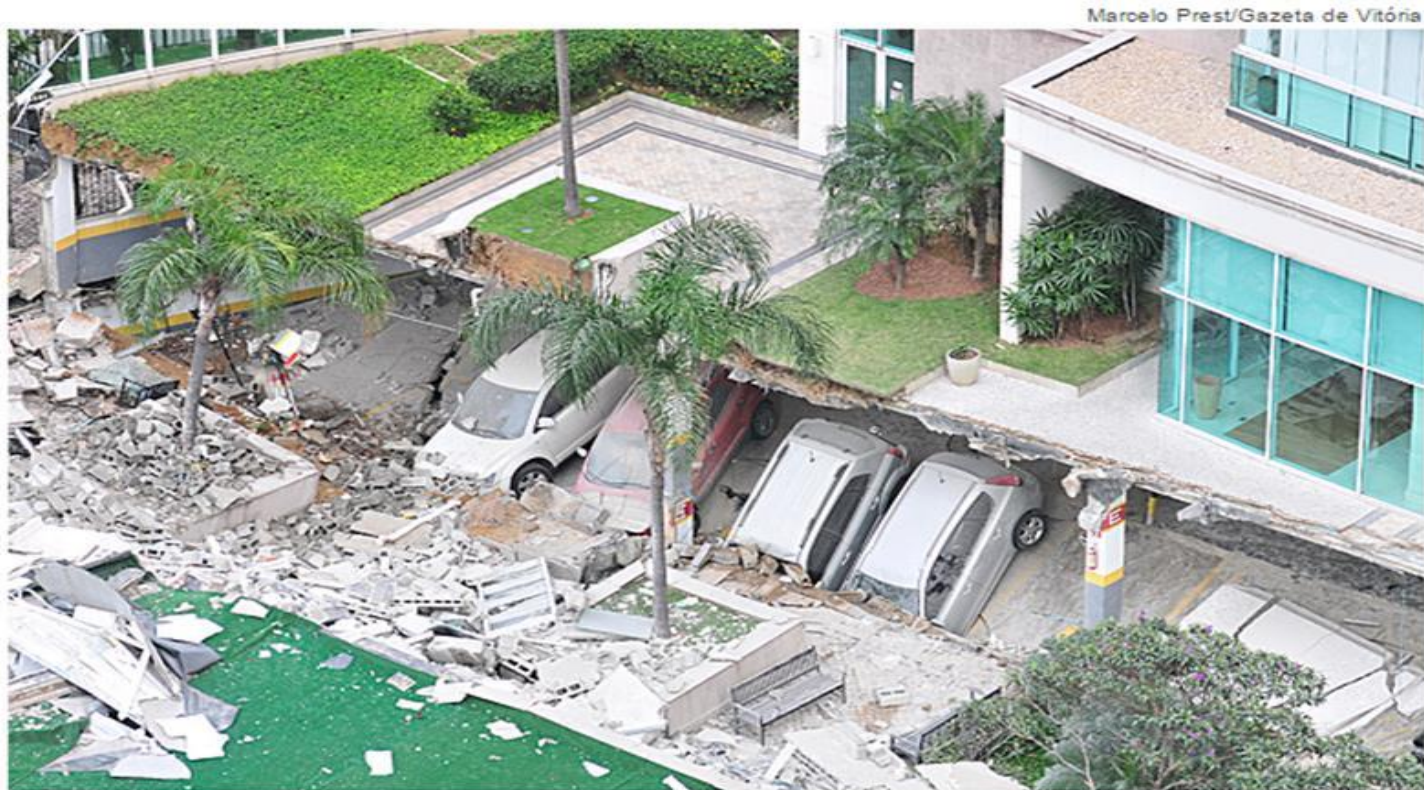
Pavimento da área de lazer cede e deixa ao menos quatro feridos em Vitória (ES)
